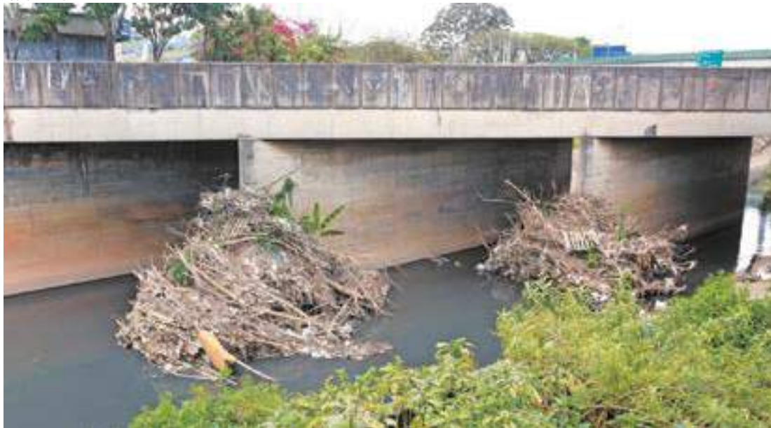
Perigo - Monte de sujeira pode obstruir a passagem da água e provocar enchentes com as chuvas
